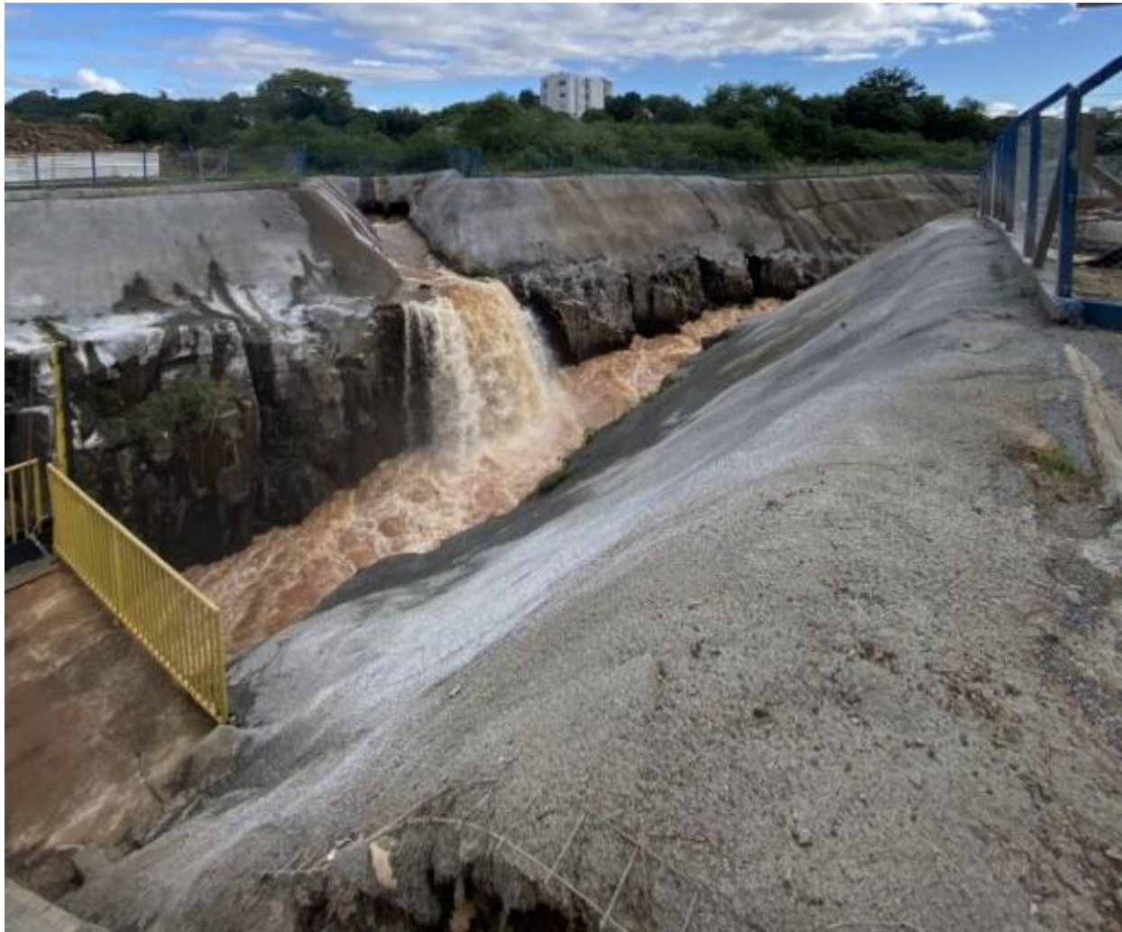
Figura 27 - Túnel de Contenção de Cheias
